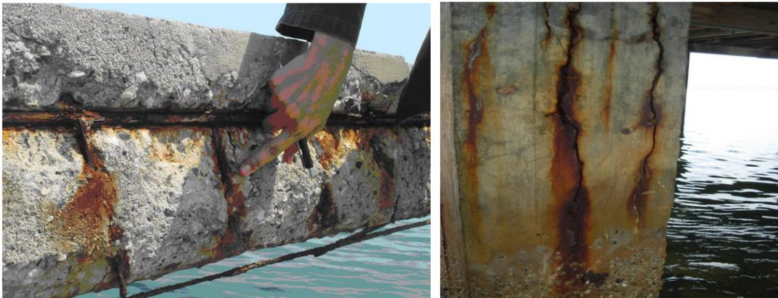
รูปที่ 1 ความเสียหายของโครงสร้างคอนกรีตเสริมเหล็กในสิ่งแวดล้อมทะเล
