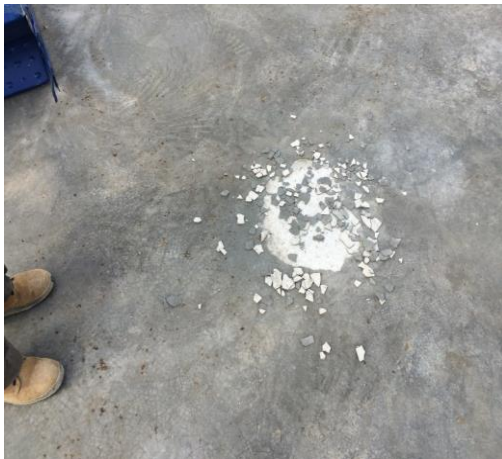
3. การแตกร้าวจากการ Bleeding และ Shrinkage
