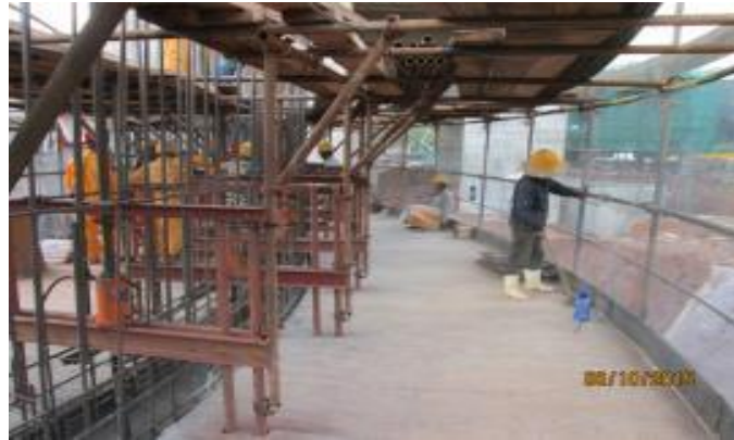
รูปที่ 4 การทำงานใน Operation Platform
