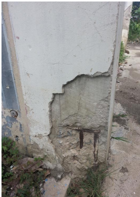
รูปที่ 1 เสาดัดพื้นดินมักเสียหายจากเหล็กเป็นสนิมได้ง่าย เมื่อใช้งานไปประมาณ 30-40 ปี
