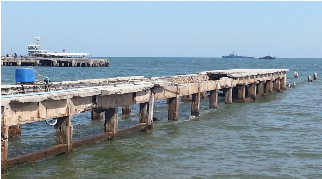
รูปที่ 2 โครงสร้างคอนกรีตเสริมเหล็กในทะเลมักเสียหายง่าย แม้ว่าใช้งานเพียงไม่กี่ปี
