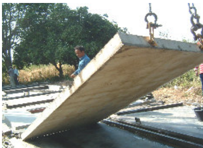
รูปที่ 2 การถอดแบบโดยใช้จุดยกที่ฝังไว้ก่อนการเทคอนกรีต
