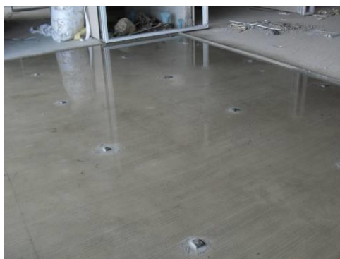
การขังน้ำที่ผิวคอนกรีตเดิม
