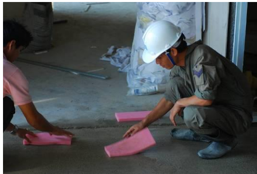
การซับน้ำที่ผิวคอนกรีต
