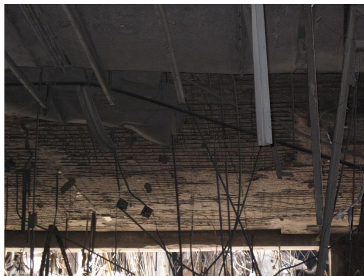
รูปที่ 2 คอนกรีตถูกไฟไหม้จนกระทั่งกระเทาะหลุดออกจากพื้น เหล็กเส้นหลุด ห้อย ไม่คงสภาพเป็นโครงสร้างคอมโพสิต
