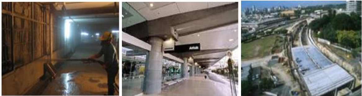
รูปที่ 1 ตัวอย่างการใช้ crystalline materials ในโครงสร้างคอนกรีตเสริมเหล็ก
