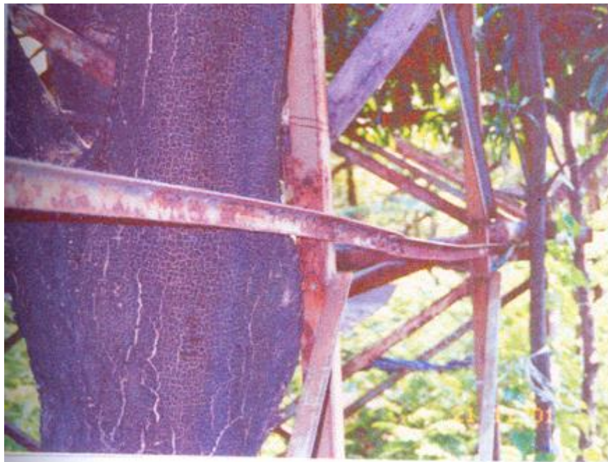
รูปที่ 4. โครงสร้างบิดงอเสียหายเนื่องจากต้นไม้
