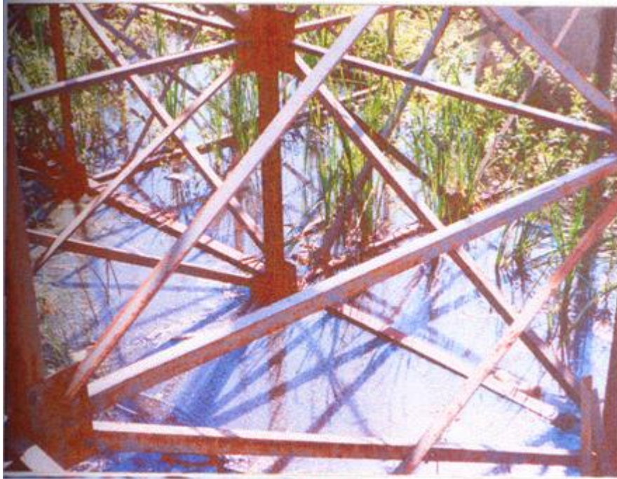
รูปที่ 3. การกักร่อนเนื่องจากโครงสร้างตั้งอยู่ในแอ่งน้ำ
