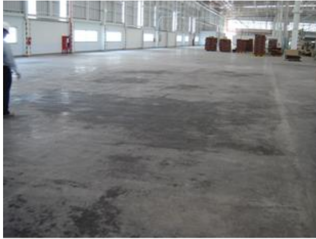
รูปที่ 3 – ความชื้นปรากฏเป็นหย่อมบนพื้นคอนกรีต แต่รอยต่อที่เป็นแนวยาวทางขวาแห้ง
