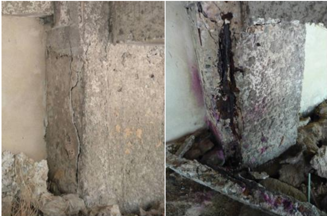
รูปที่ 3: การแตกร้าวของตอม่ออาคารคอนกรีตเสริมเหล็ก
