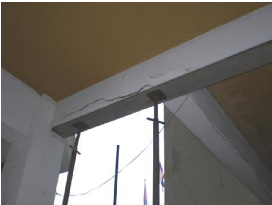
รูปที่ 2: การแตกร้าวตามแนวยาวอันเนื่องมาจากการขึ้นสนิมในคานคอนกรีตเสริมเหล็ก
