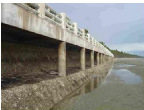
รูปที่ 1 โครงสร้างคอนกรีตเสริมเหล็กในสิ่งแวดล้อมทะเลของไทย
