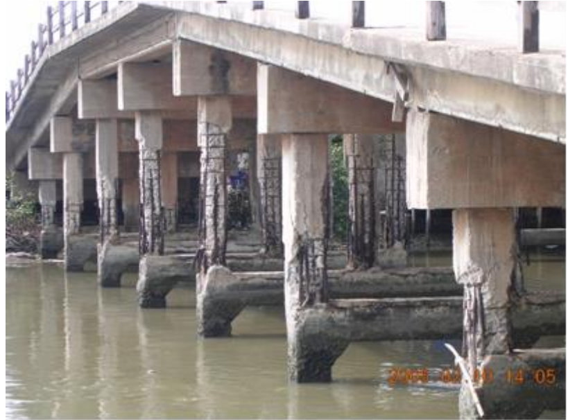
รูปที่ 1 ระดับความเสียหายที่แตกต่างกันในแต่ละส่วนของโครงสร้าง
