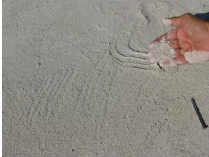
รูปที่ 1 – ผิวหน้าคอนกรีตที่เป็นฝุ่นและหลุดร่อนเมื่อถูกขีดข่วน
