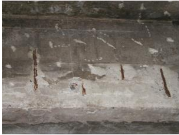
รูปที่ 1 คานคอนกรีตเสริมเหล็กที่เกิดสนิมและทำให้เกิดการแตกร้าวและหลุดร่อนของคอนกรีต
