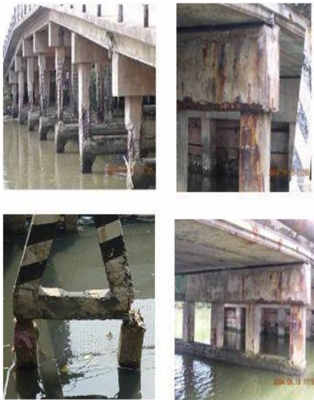
รูปที่ 5 โครงสร้างเสื่อมสภาพจนค่าใช้จ่ายในการบูรณะซ่อมแซมสูง หรือใช้การไม่ได้จนต้องทุบทิ้งสร้างใหม่
