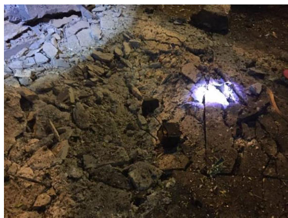
รูปที่ 2 ความเสียหายของพื้นคอนกรีตบริเวณที่มีการระเบิด (จากสื่ออินเทอร์เน็ต)
